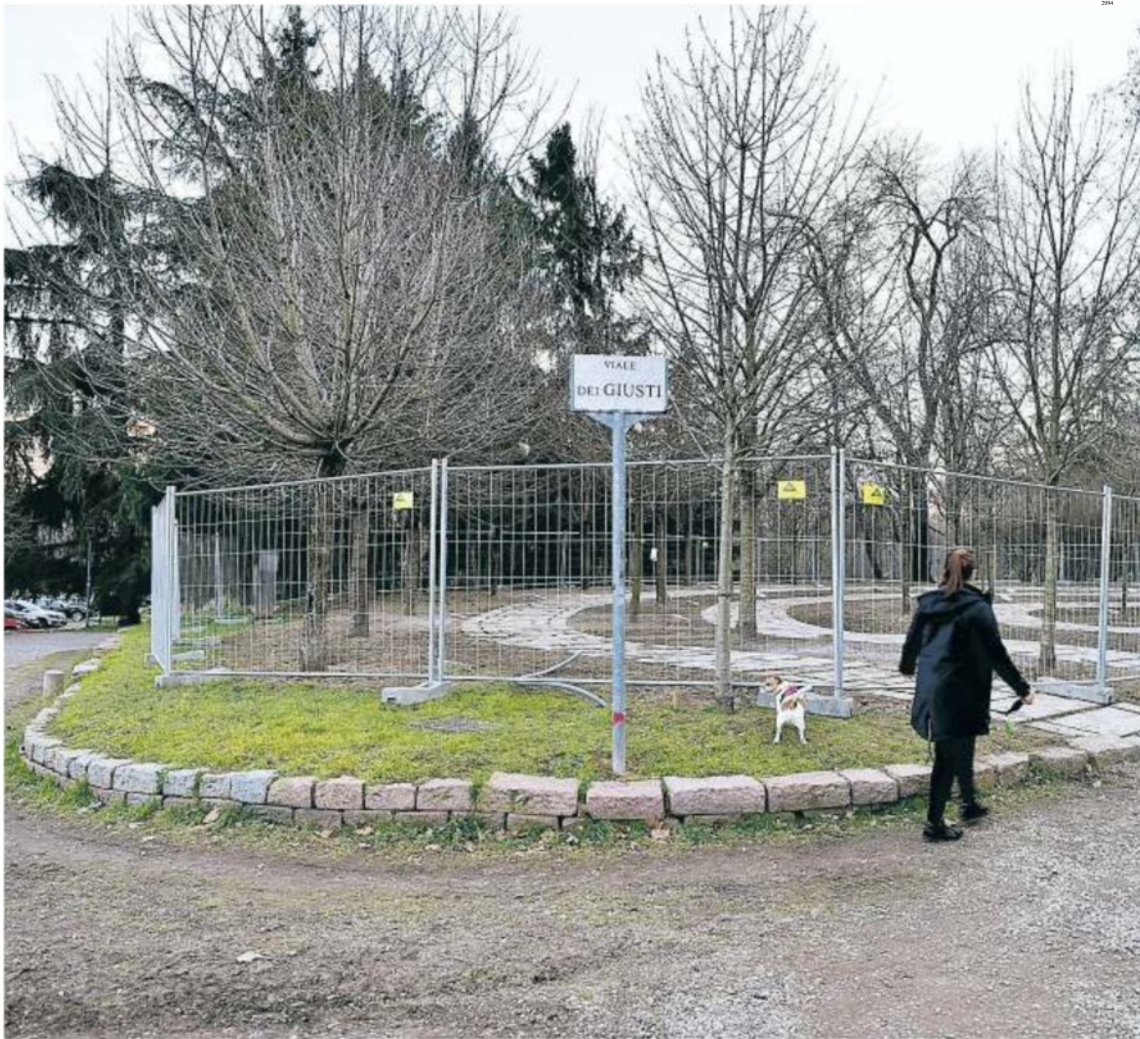
Il cantiere I lavori erano iniziati da settimane, i nuovi vialetti sono già stati posati
